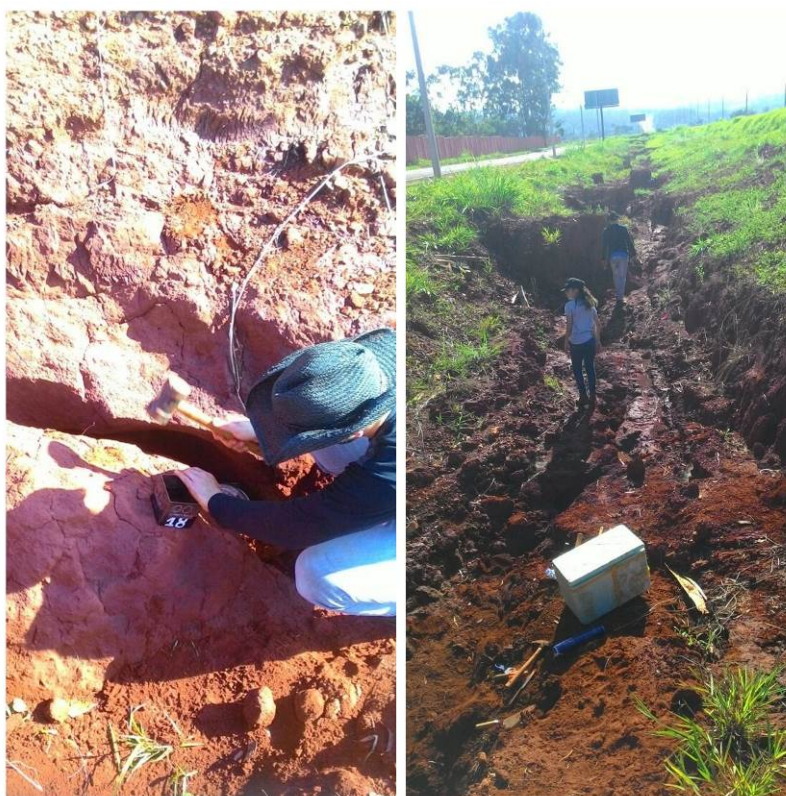
Figura 1: Erosão próxima a GO-020.
